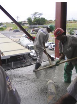
Aplicação do concreto CAA (fck 30 MPa) na obra do Shopping Flamboyant (Jardim Goiás Empreendimentos)
