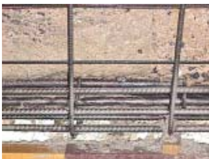
Viga armada com reforço e submetida a limpeza com jato de água e areia
