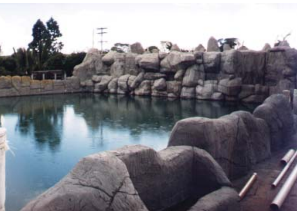
A composição das pedras que cercam a piscina de ondas das Thermas dos Laranjais, antes da pintura final, e o trabalho de acabamento na caverna (foto menor)
