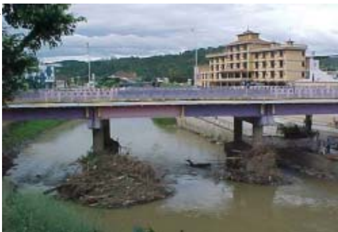
Antes: entulho nos pilares
