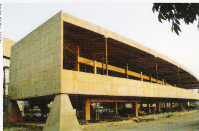
Etapas: estrutura do Museu BR (à esq.); maquete da futura Catedral Católica (abaixo, à esq.); e o edifício do Memorial, com inauguração prevista para novembro (abaixo)
